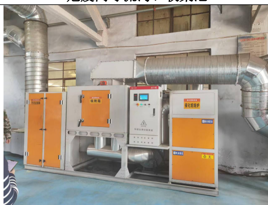
现有工程废气处理设施（催化燃烧装置）
